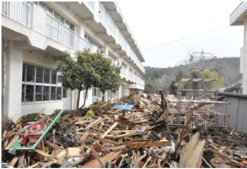
津波直後の様子 (高田小学校)
