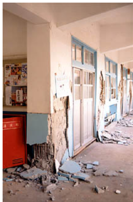
2-4. 校舎の壁がこわれ、ドアがまがって開かなくなった（神戸市須磨区）
