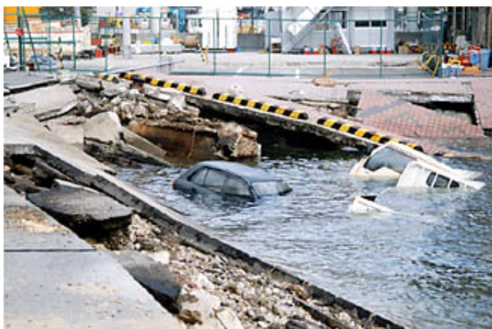
3-5. 神戸港の岸壁がこわれ港は機能しなくなった
