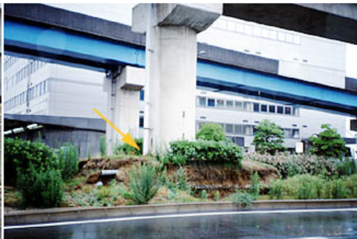
3-10. 液状化が大規模に生じたポートアイランドでは地盤が沈下し、建物が抜け上がった（神戸市中央区）
