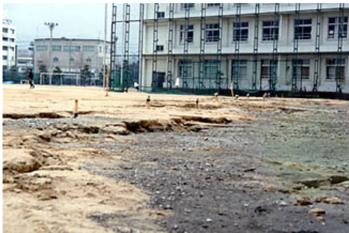
3-9. 校庭に生じた液状化と亀裂（神戸市兵庫区）
