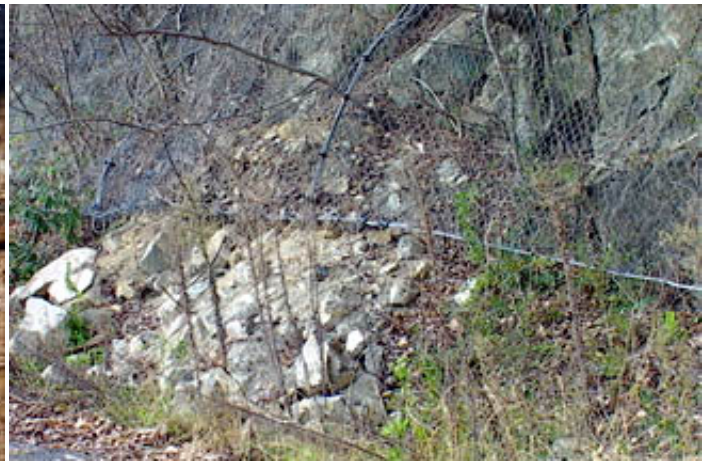
くずれた花こう閃緑岩 （中央区葺合町） 六甲山では、あちこちでくずれた花こう閃緑岩が見られます。
