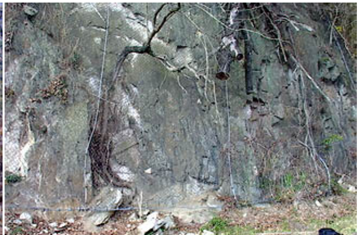
花こう閃緑岩でできた山肌 （中央区葺合町） 風化が進んでいるこのあたりの花こう閃緑岩はくずれやすく、ネットがかけられています。
